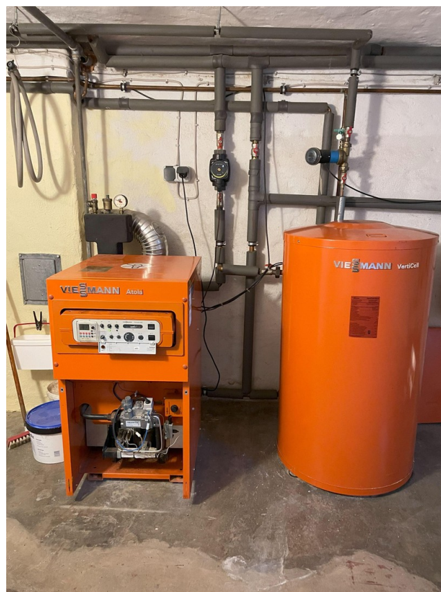
Heizungsanlage im KG
