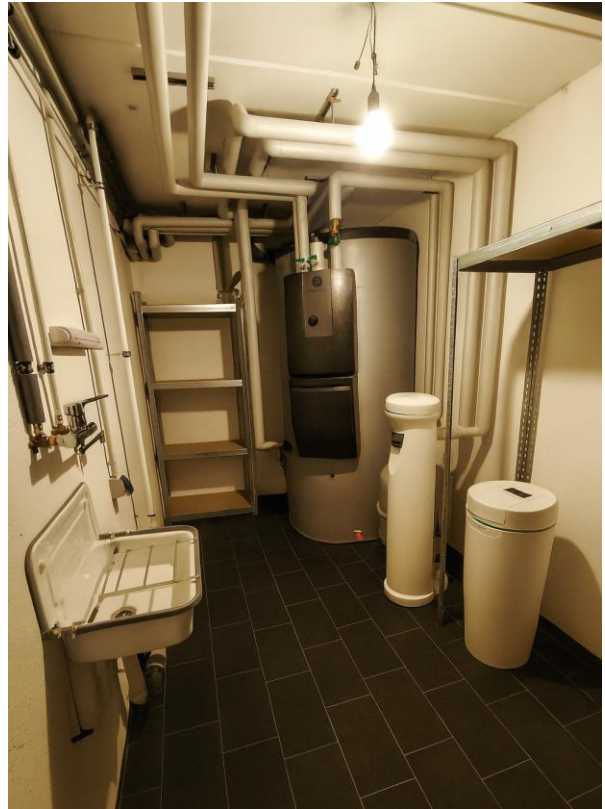
Technikraum & Übergabestation Nahwärmekraftwerk Untergeschoss
