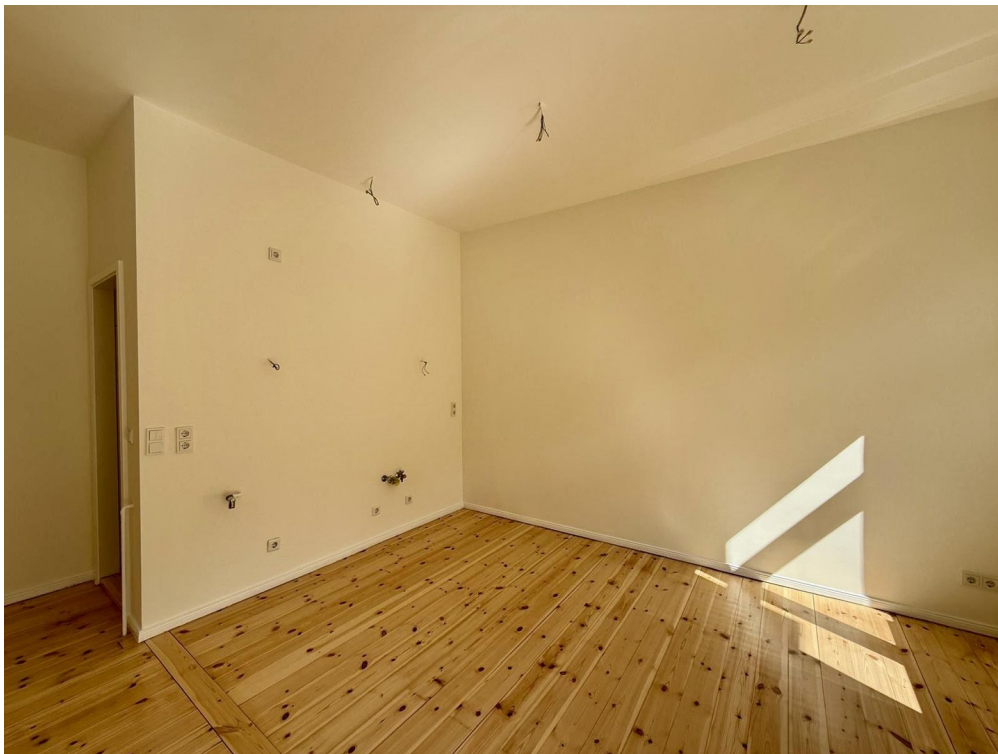
Küchenecke mit Anschlüssen
