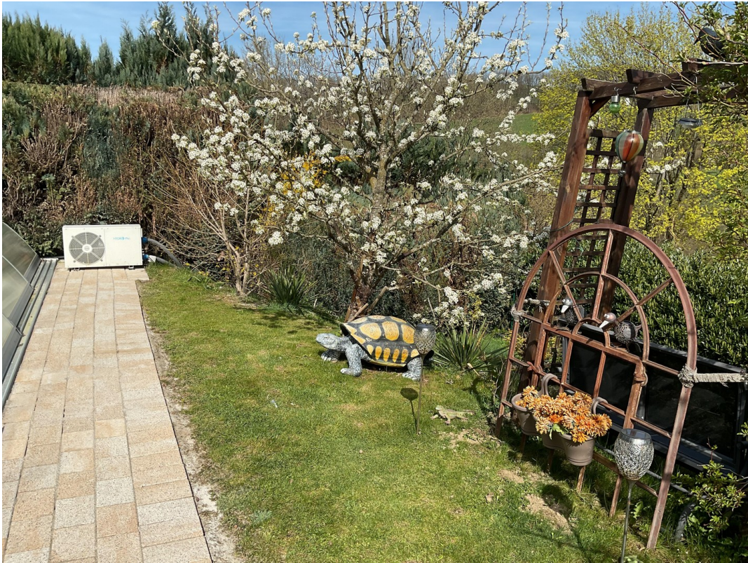
Grundstück Heizung Pool
