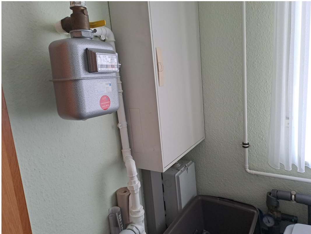
Hausw.raum / Anschl. Strom+Gas
