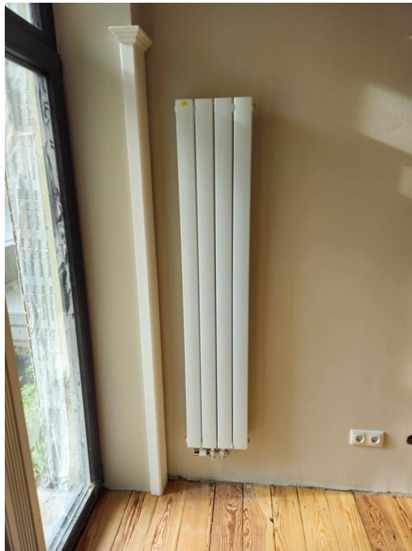
Design Heizkörper Küche
