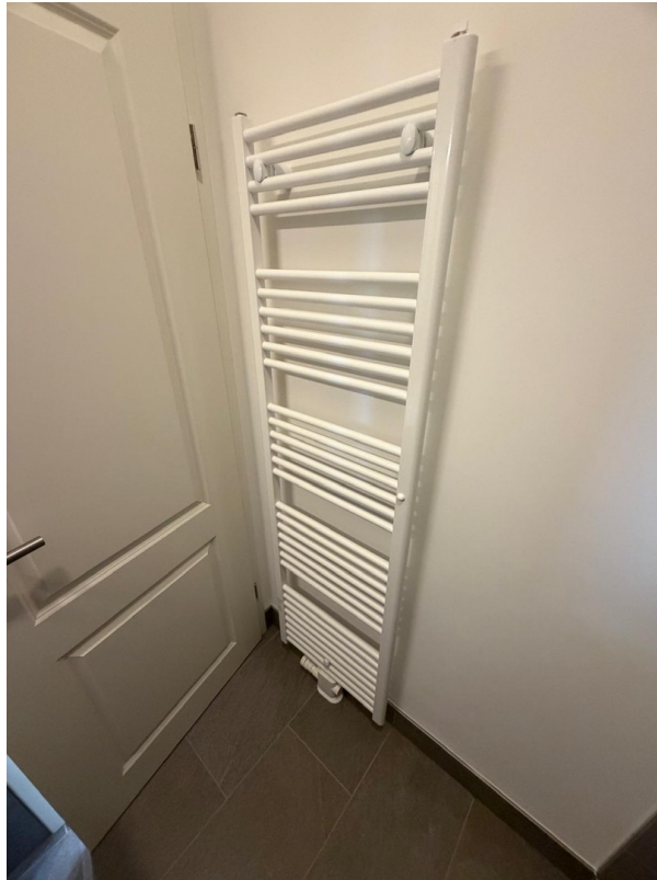
Heizung im Bad
