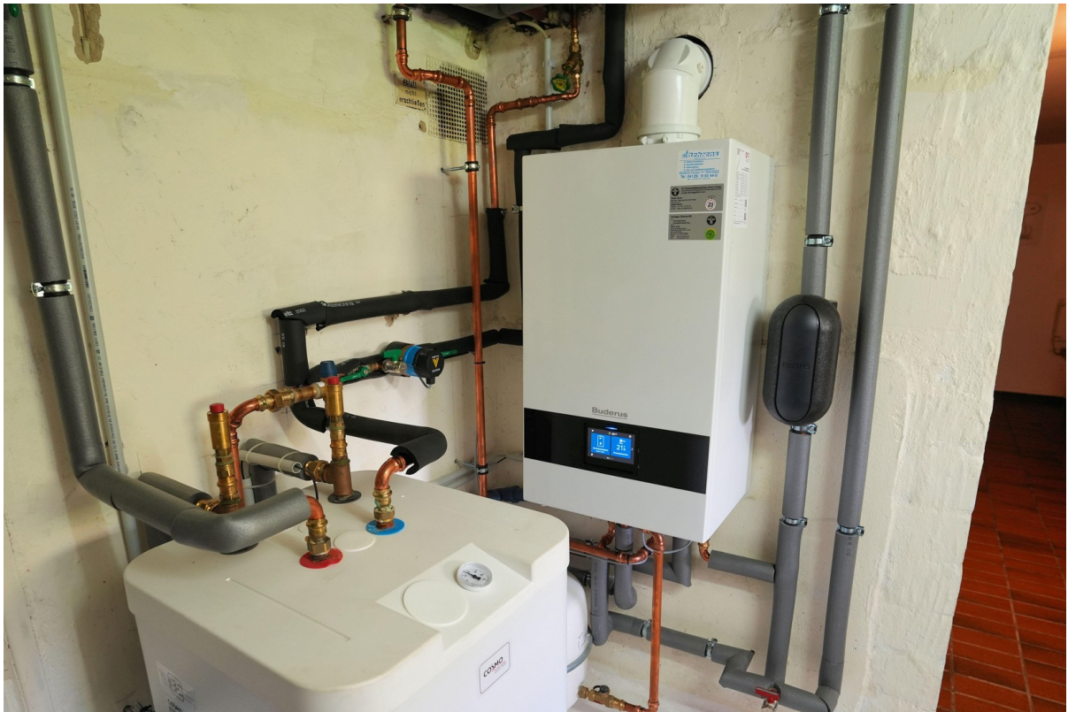
Heizung im Keller
