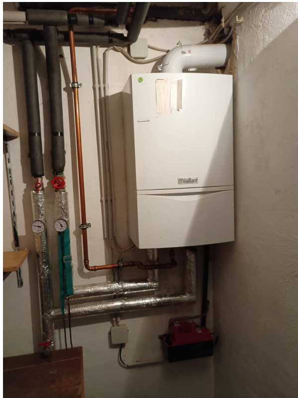
Gastherme im Heizungskeller
