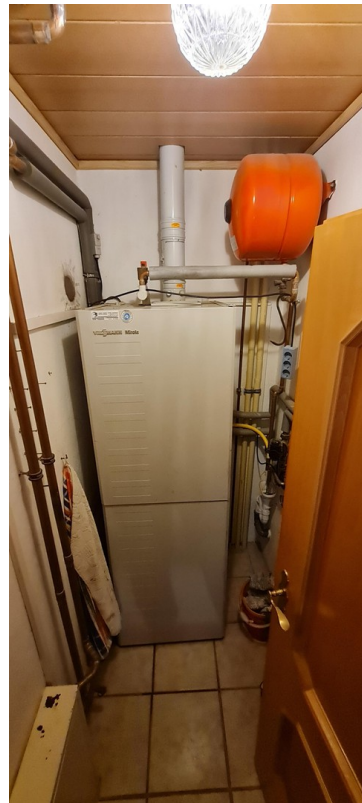
Heizung Brennwert (872GEG)
