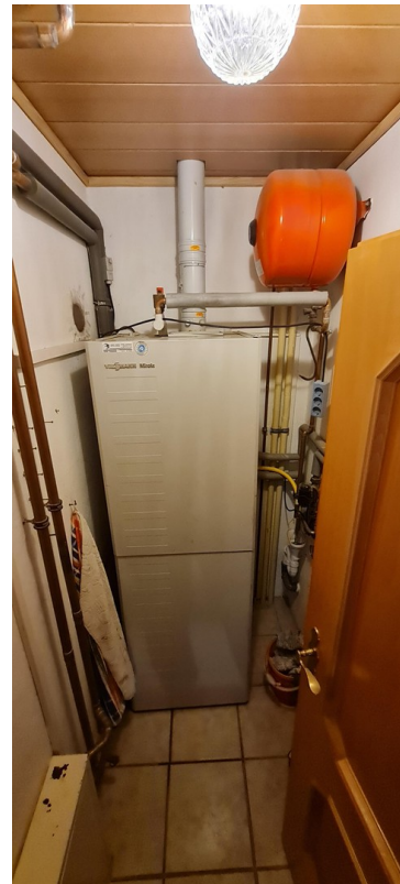
Heizung Brennwert (872GEG)
