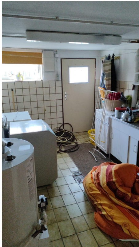
Keller Heizung Ausgang Garten
