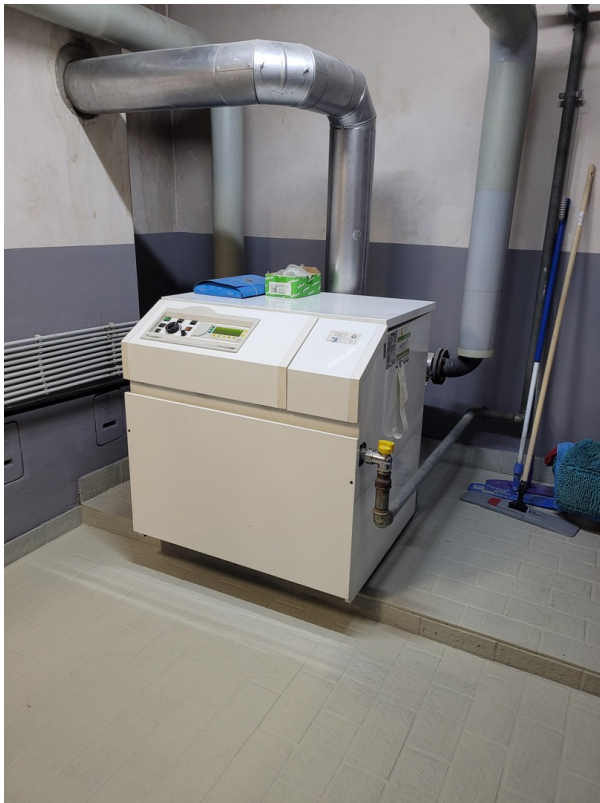
Gas Zentral Heizung BJ. 2004
