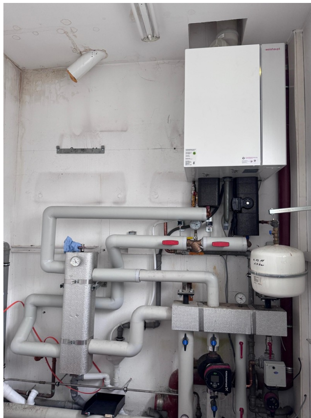
Heizkessel 90 kW heizt 2000m 2
