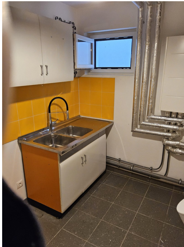
1.UG Technikraum/ Waschküche
