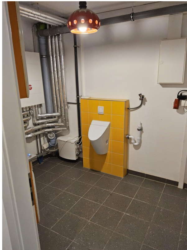
1.UG Technikraum/ Waschküche
