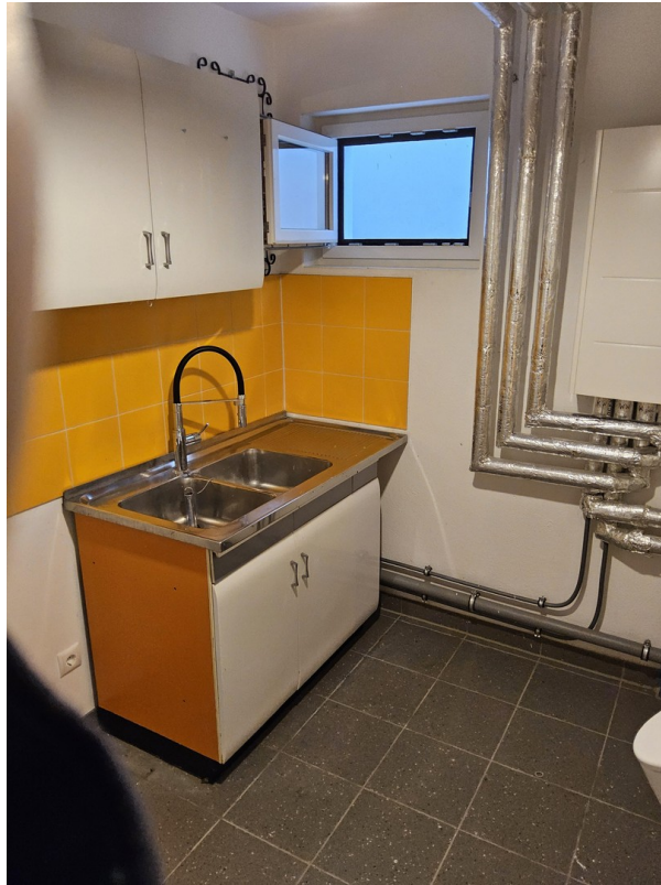
1.UG Technikraum/ Waschküche
