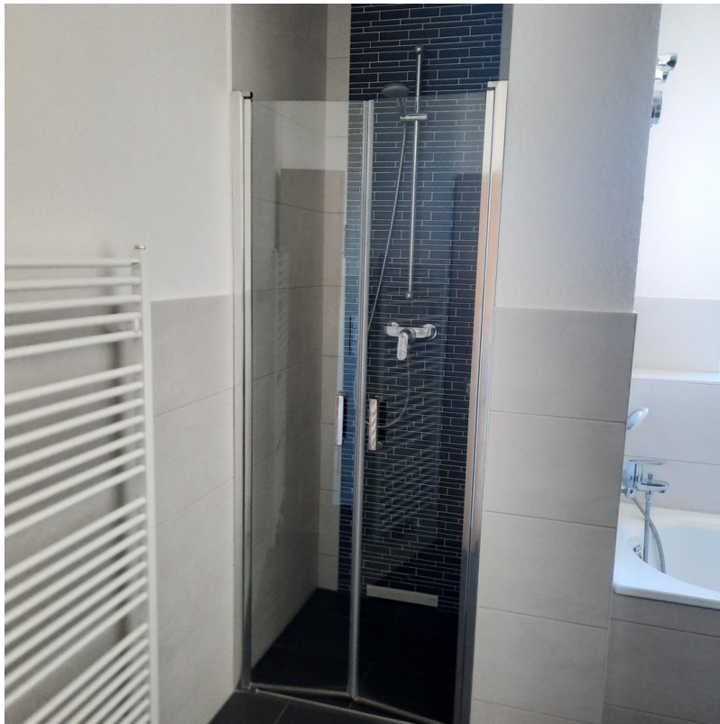
Dusche mit Schwingtür
