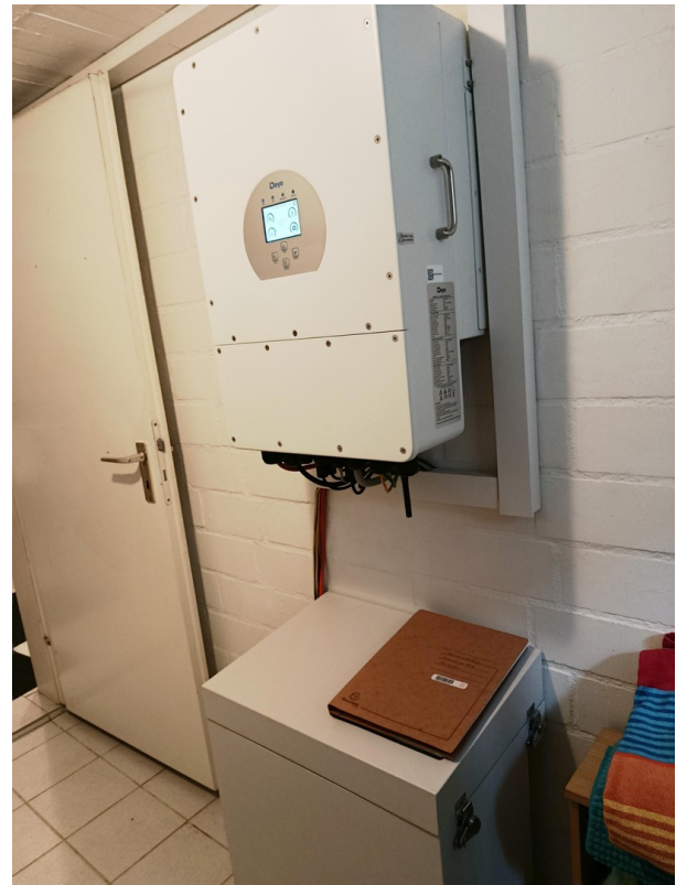
PV-Wechselrichter u. Speicher
