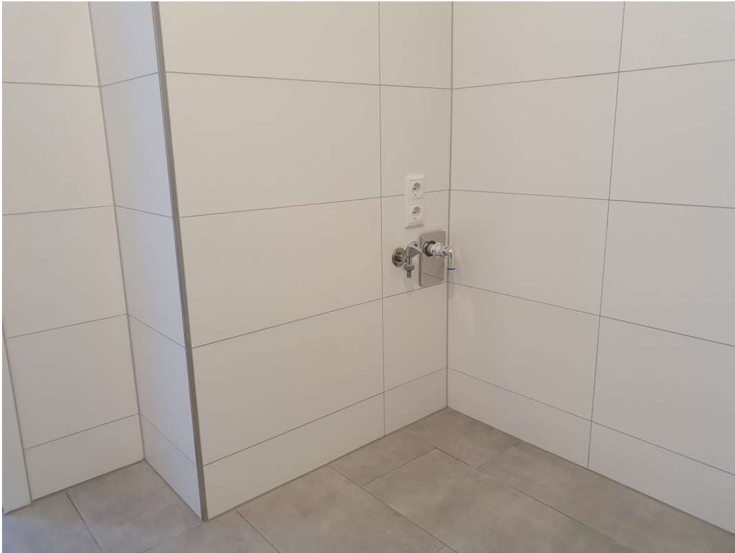
Waschmaschinenanschluss im Bad
