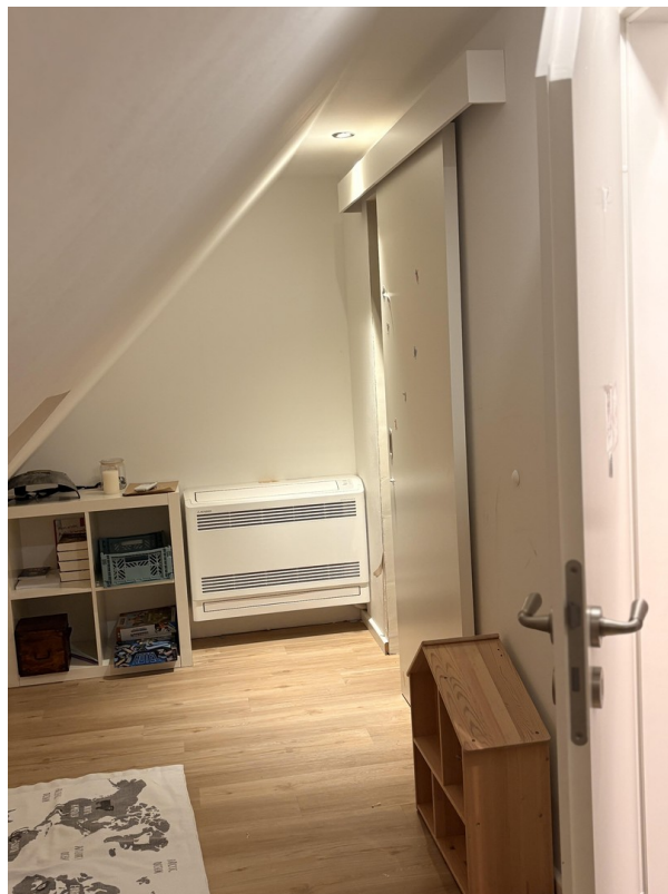
Klimagerät auf Dachboden
