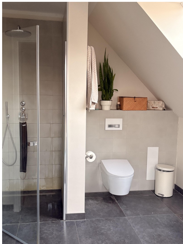
Dusch-WC und Dusche
