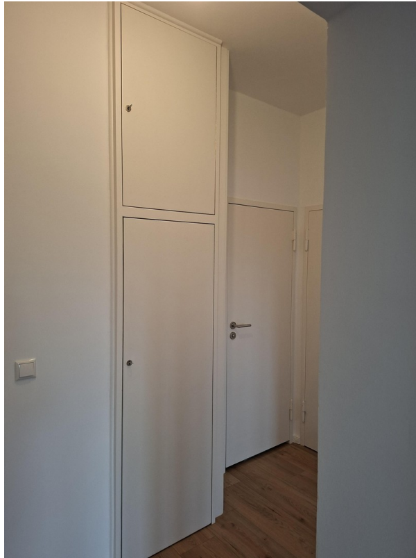
Wandschrank im Flur
