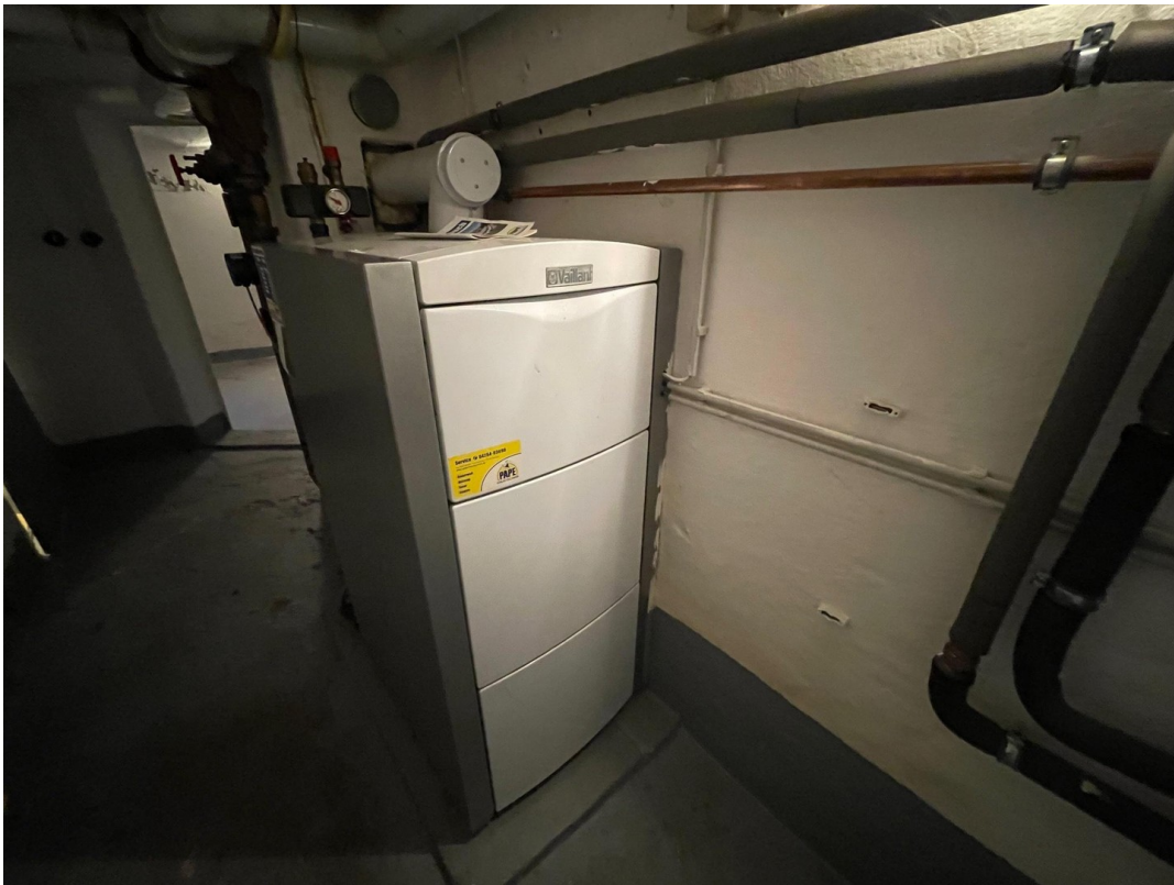
Vaillant Gasheizung aus 2011
