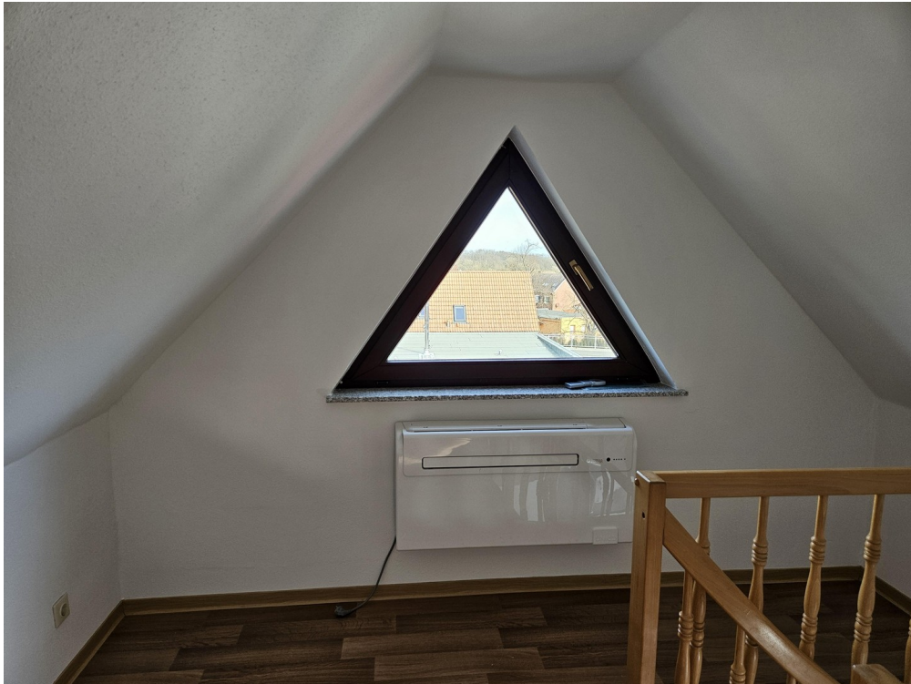
Klimaanlage im Schlafzimmer
