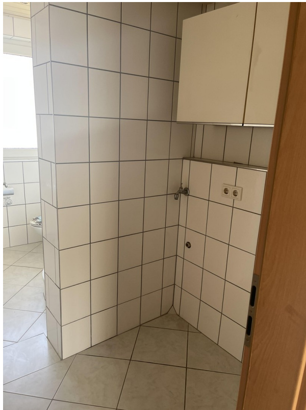
Bad Anschluss Waschmaschine
