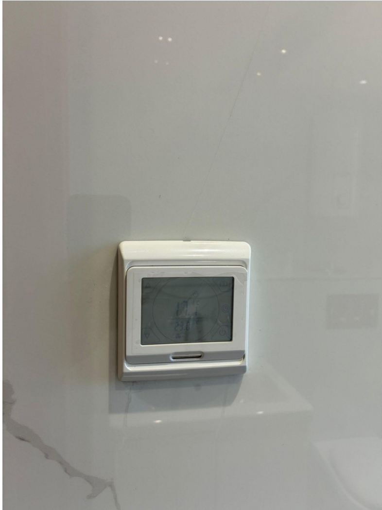
Fußbodenheizung im Badezimmer
