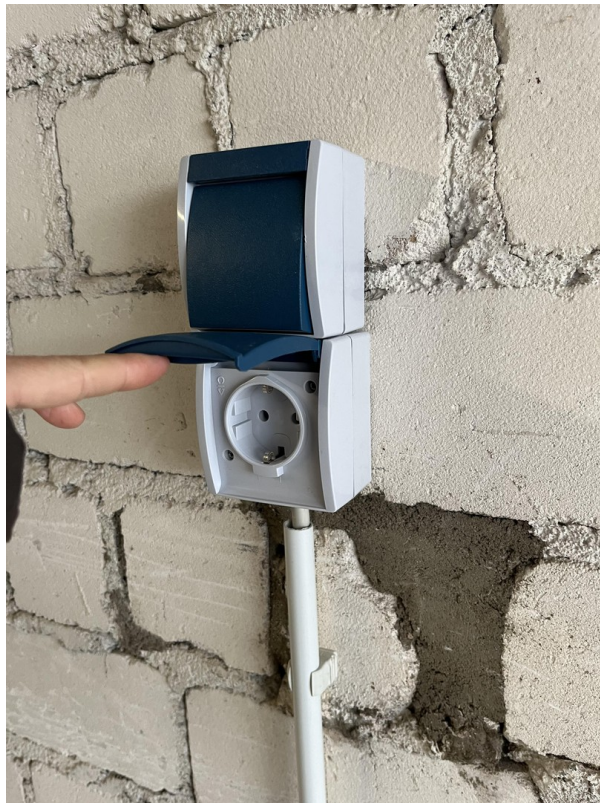
Strom und Licht Garage
