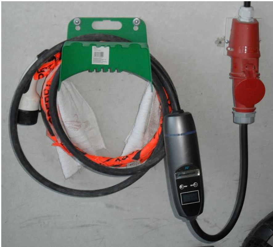
EV Ladekabel 22kW, Garage
