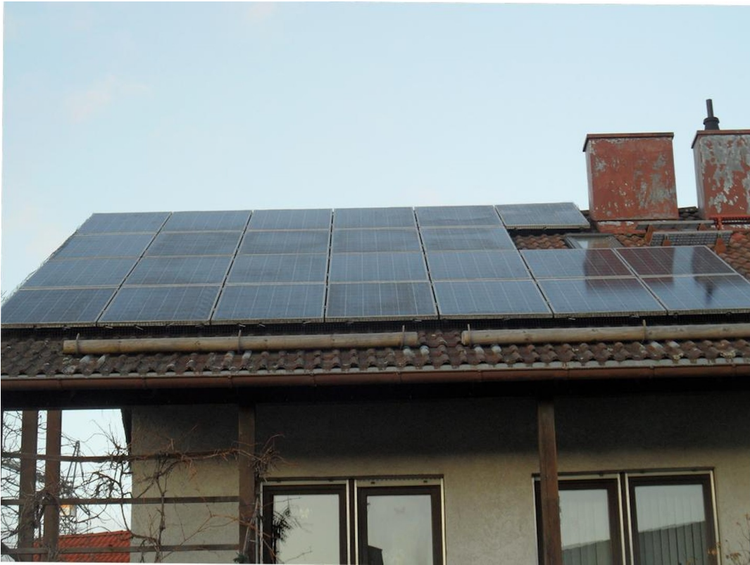
PV-Anlage ca. 23 qm, 5.3 kWp
