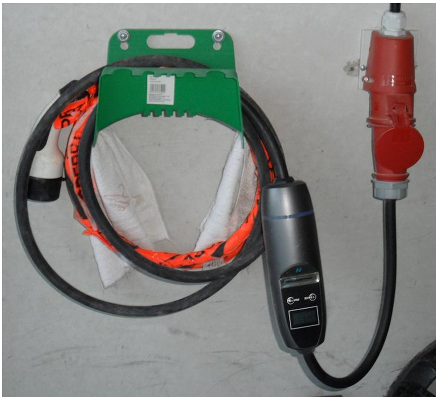
EV Ladekabel 22kW, Garage
