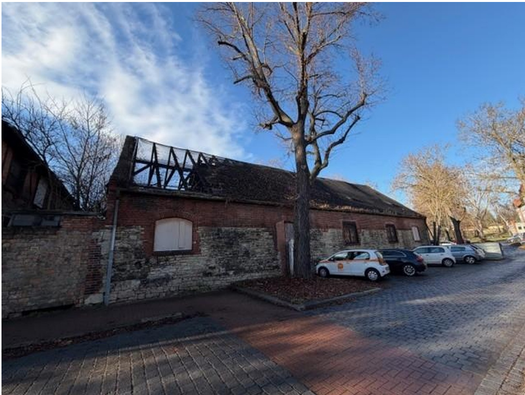
Lager mit Brandschaden
