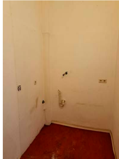
Hauswirtschaftsraum mit Waschmaschinenanschluss
