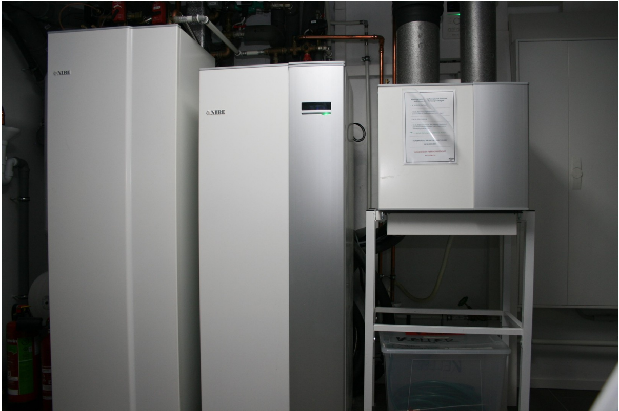
Nibe Heizung & Lüftung
