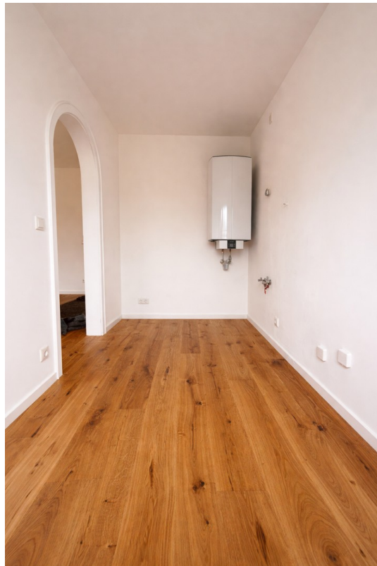
Küche neuer dezent. WW-Boiler
