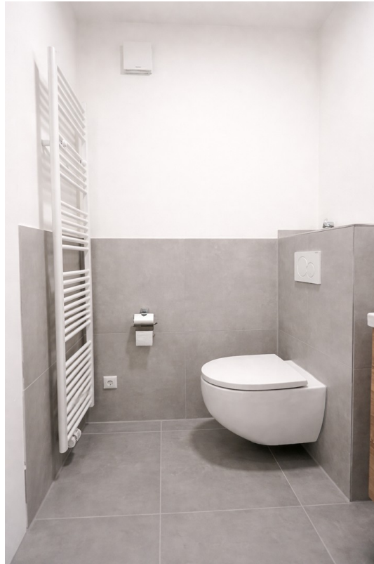
Bad WC spülrandlos
