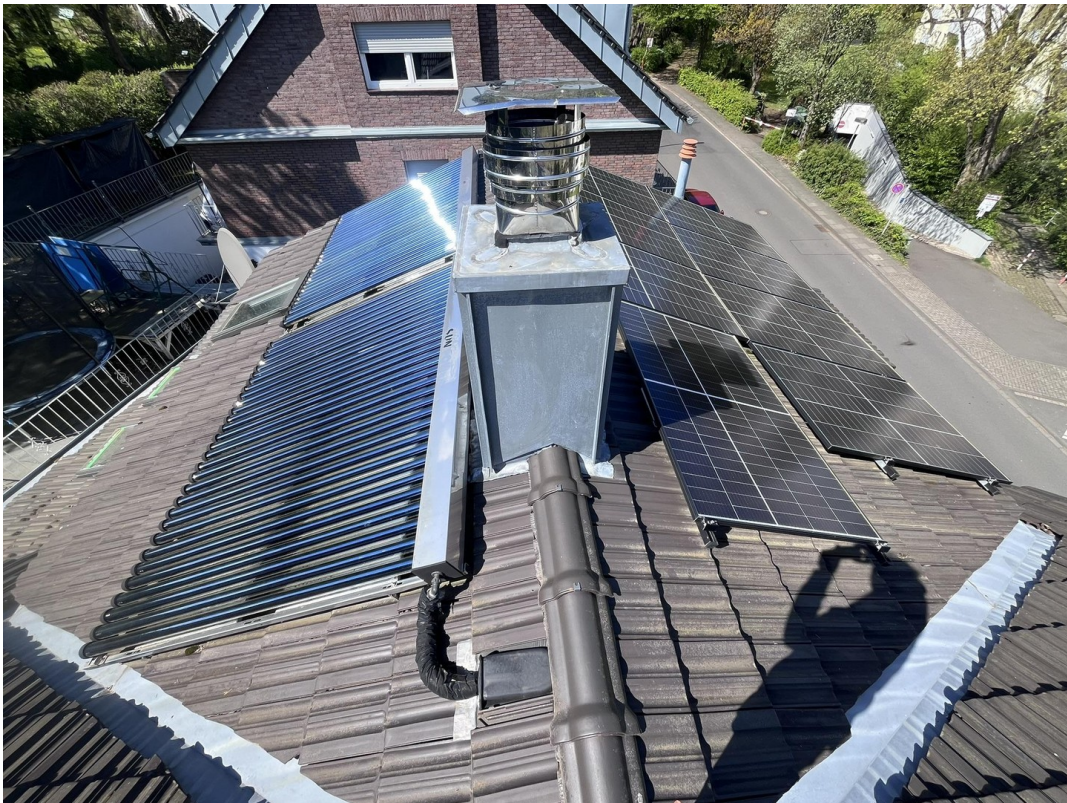
PV und Solarthermie
