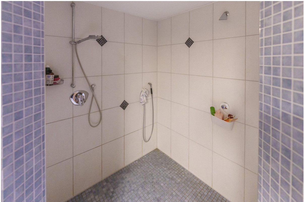
Dusche für Sauna
