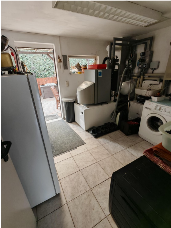
Heizung und Waschraum
