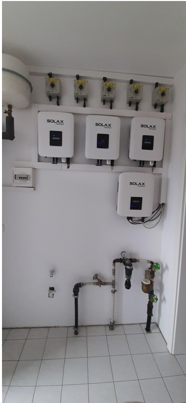
Wechselrichter der Anlage
