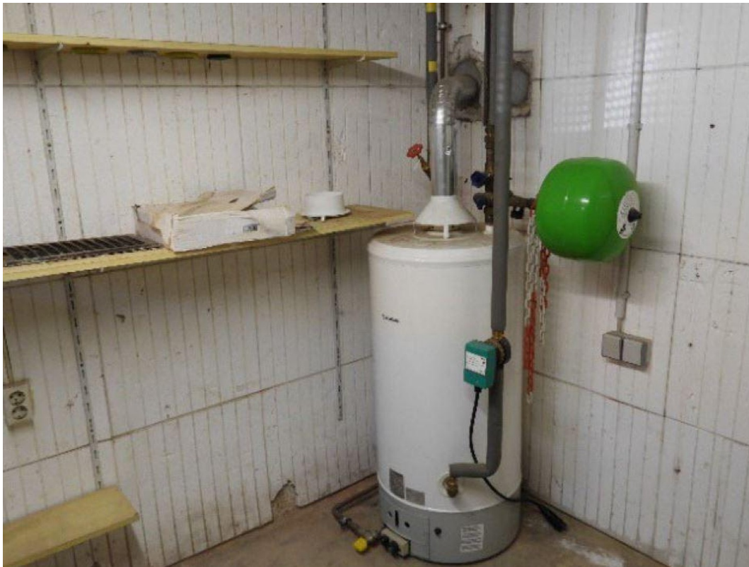
Warmwassererzeuger und Speiche
