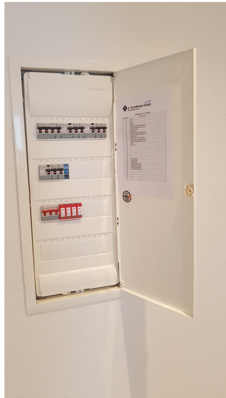
Neue Elektroinst. 4 OG rechts
