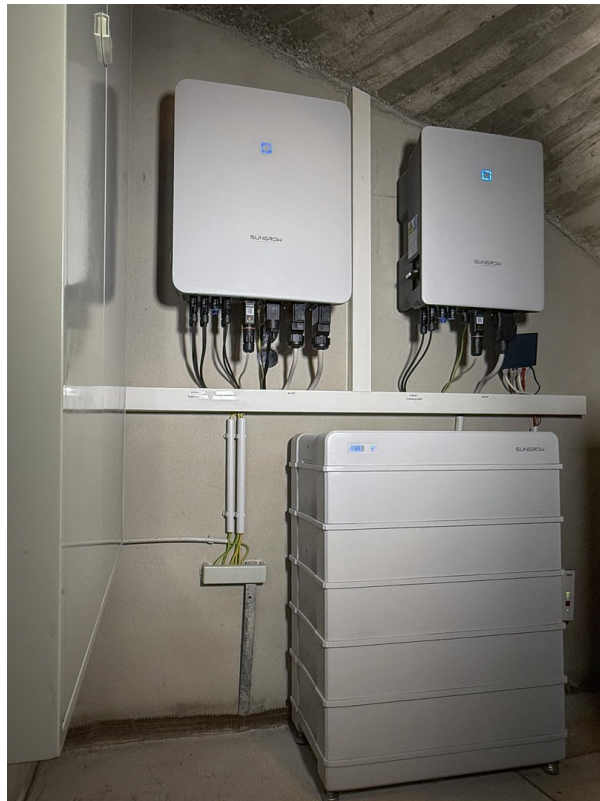
PV: Wechselrichter und Speicher
