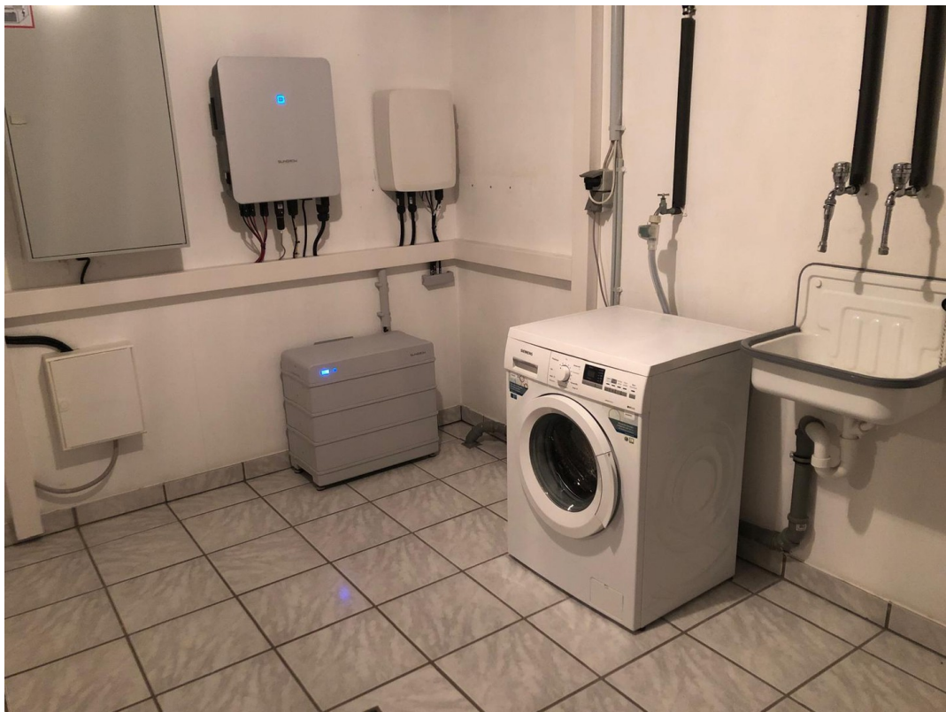
Waschküche/PV Anlage Batterie
