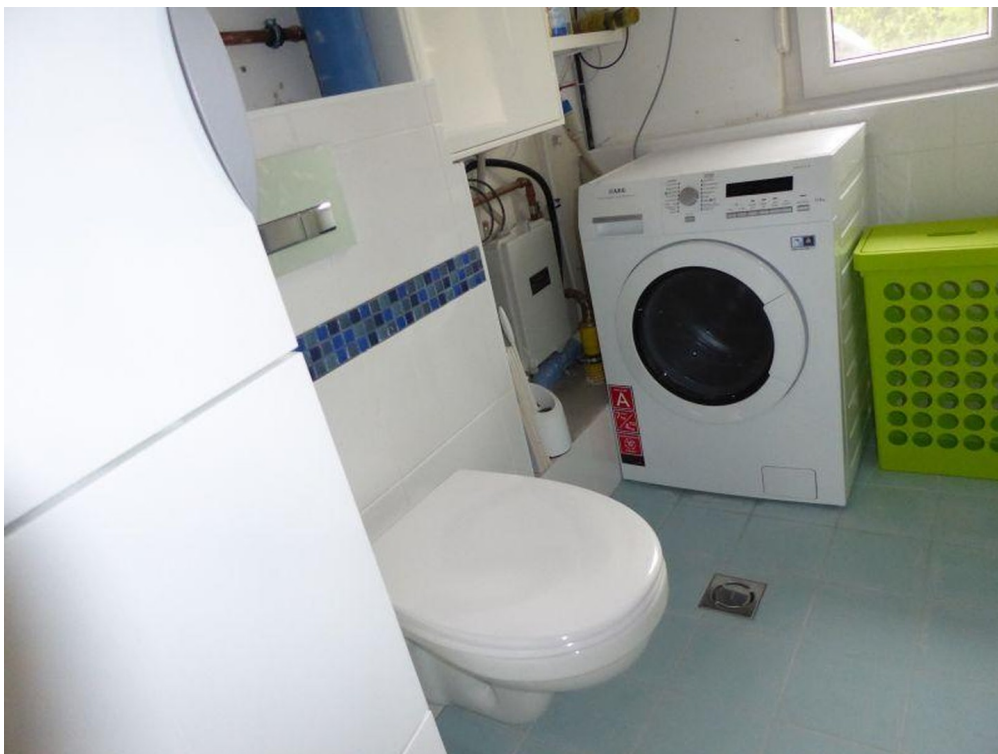
WC im Technikraum
