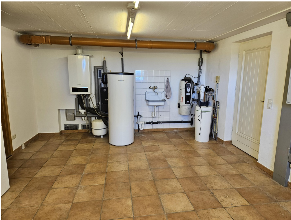
KG Technik im Hausanschlußraum
