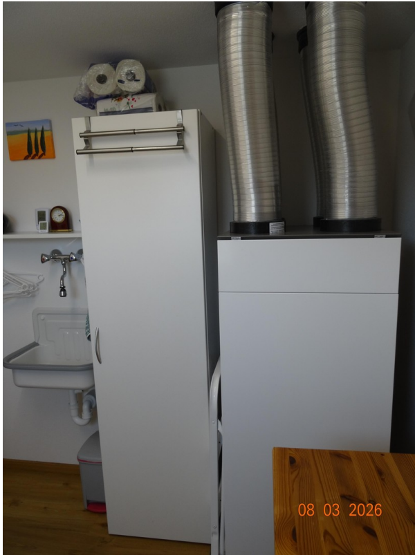
HWR, Lüftungsanl. m. Wärmetaus
