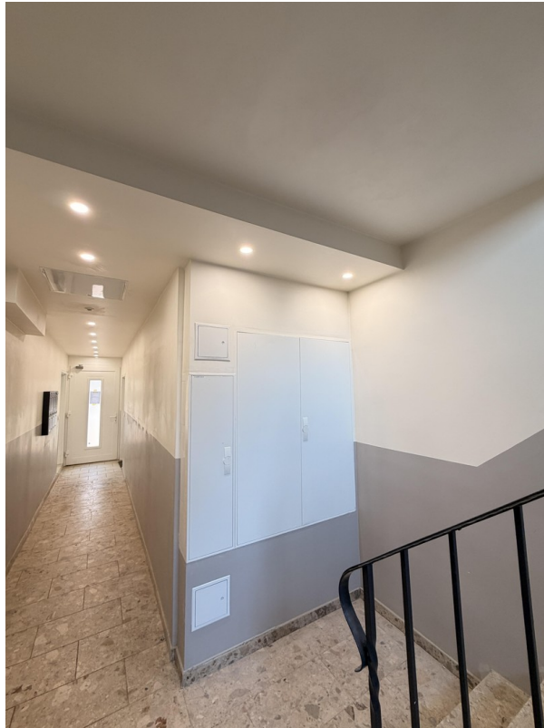
Treppenhaus mit Zählerschrank
