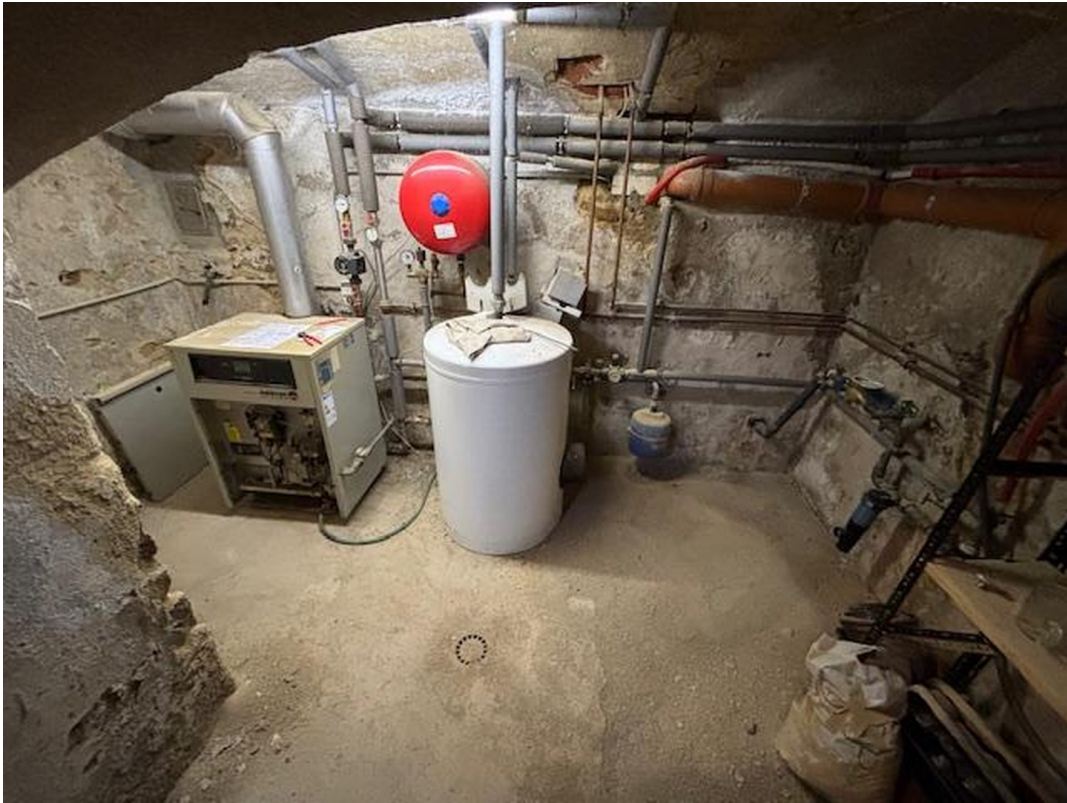
Heizung / Gasterme mit Puffer
