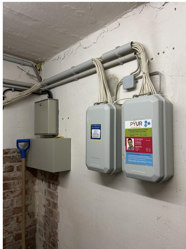
Hauptanschluss im Keller
