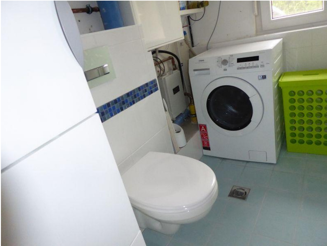
eingebautes WC Technikraum
