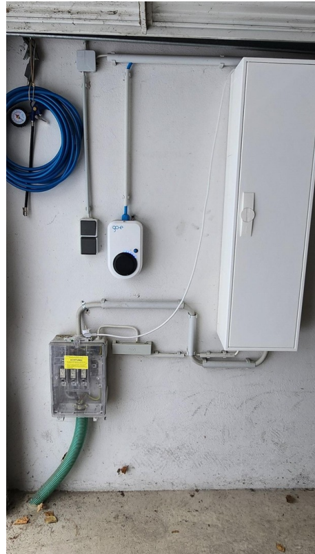
Wallbox und Stromanschluß
