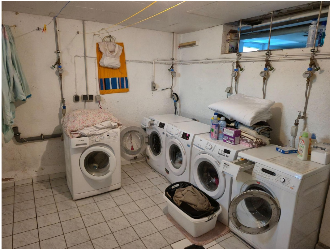
Wasch- und Trockenraum
