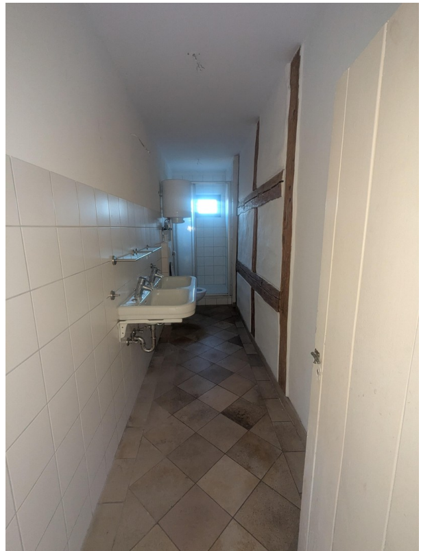
Duschbad mit WC
