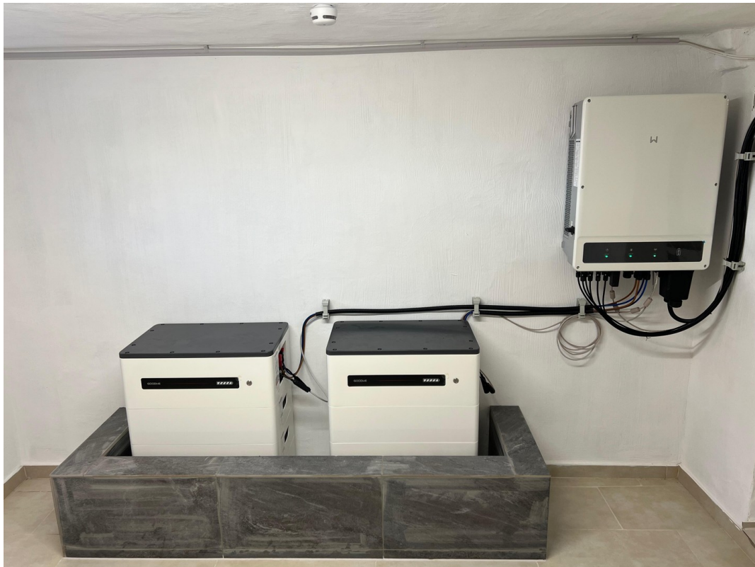
PV Speicher im Keller
